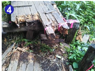
木道の一部が老朽化のため、段差が発生しています。お気を付けてご通行ください。
